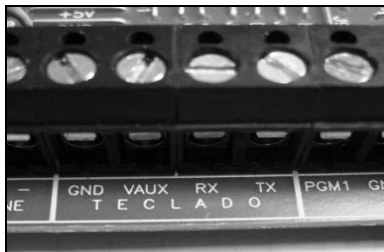
Figura 4 – Terminais do Barramento de Controle
