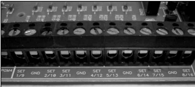
Figura 6 – Terminais de Entrada de Setores
